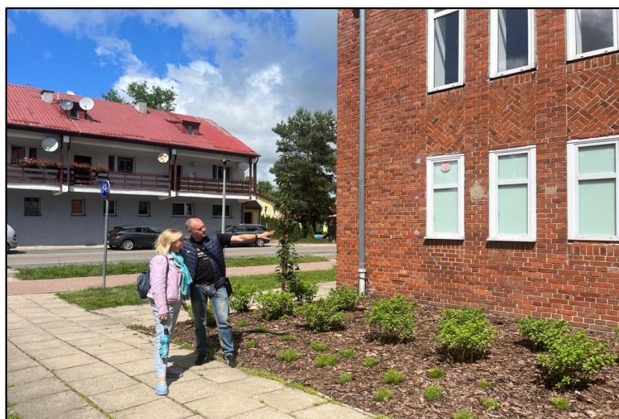
Spotkanie z przedstawicielem firmy Remes- czyszczenie elewacji, uzupełnienie fug/ realizacja nakazów PINB
