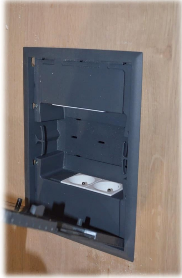
...w których zamontowano gniazda elektryczne.
